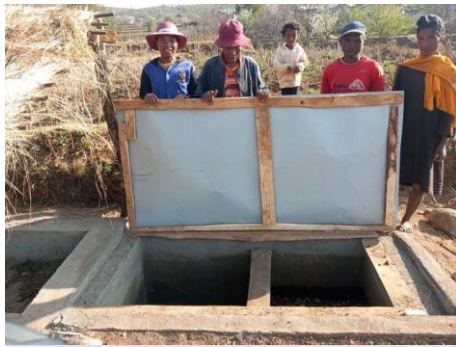
Bassin de compost liquide
