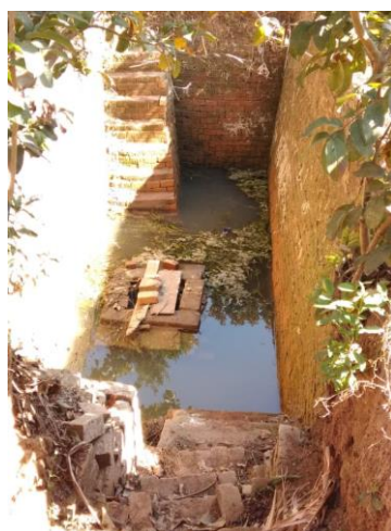
Figure 6: bassin de rétention équipé de puits à l'intérieur : Alatsinainy Ambazaha
